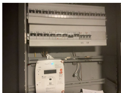
Sikringsskap på lagerrom.
