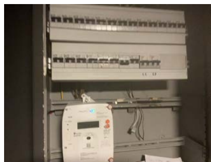
Sikringsskap på lagerrom.
