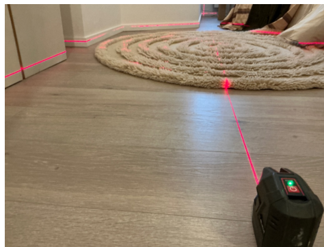
Nivellering soverom, avvik
