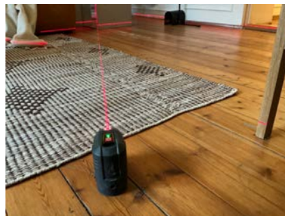
Nivellering i stue, avvik på ca. 10-20 mm
