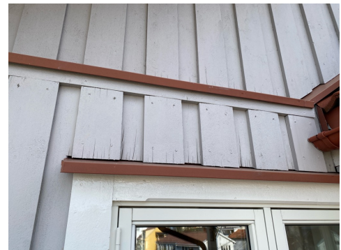
Tørkesprekker i enkelte kledningsbord
