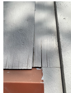
Kledningsbord med litt påbegynt råte
