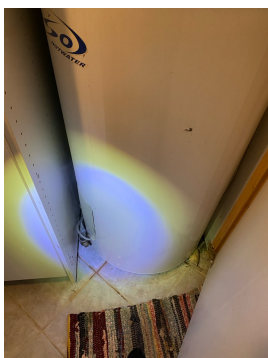
Varmtvannsbereder står i skap på vaskerom
