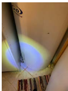
Varmtvannstank står i skap på vaskerom
