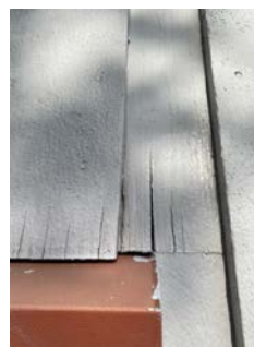
Kledningsbord med litt påbegynt råte
