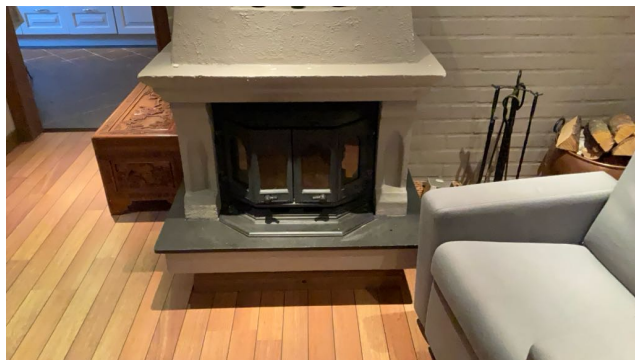
Manglende ikke brennbar plate på gulv foran peis.
