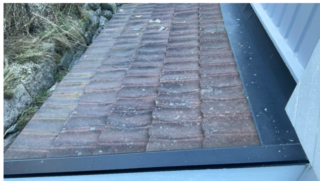
Takplater med bulker.
