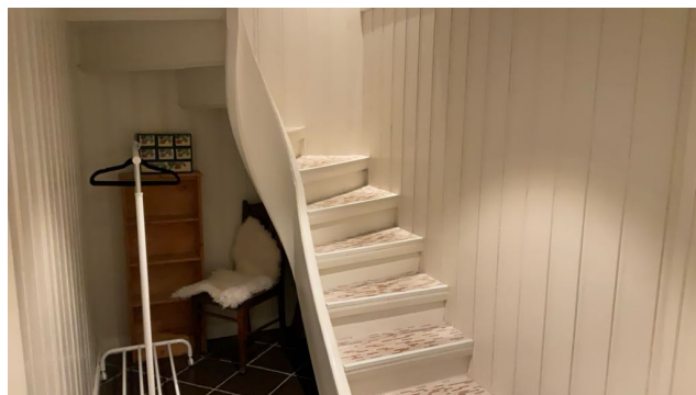
Trapp til kjeller uten rekkverk.
