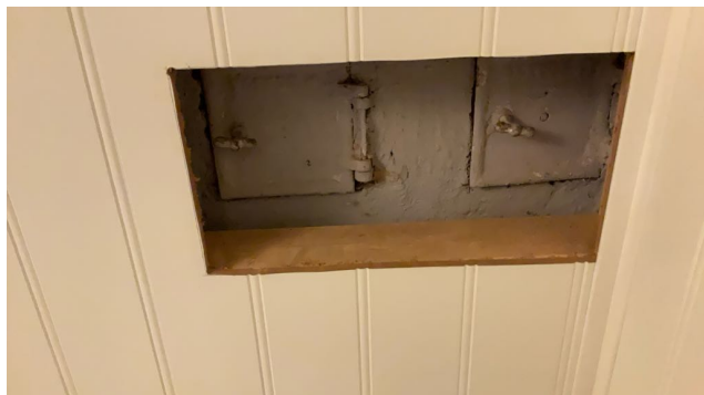
Sotluker skjult bak plater på bad/vaskerom.
