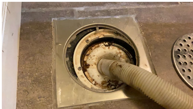
Sluk under dusjkabinett
