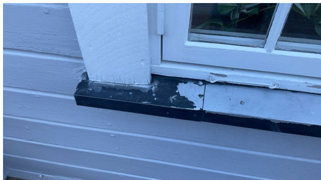
Maling på vindusbeslag flasser.
