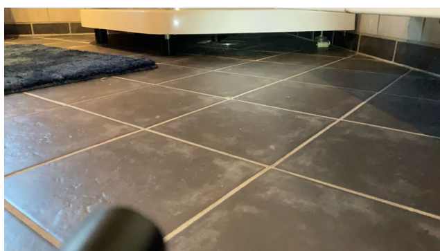
Sluk under dusjkabinett.
