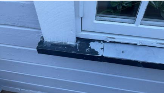
Maling på vindusbeslag flasser.
