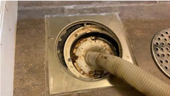
Sluk under dusjkabinett
