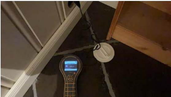
Fuktmåling i yttervegg under terreng.
