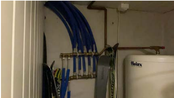
Vannrør kommer ut i rom uten sluk
