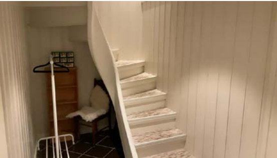
Trapp til kjeller uten rekkverk.
