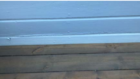
Noe begynnende råte på kledning mot sør ved terrasse
