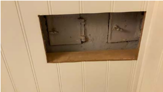
Sotluker skjult bak plater på bad/vaskerom.
