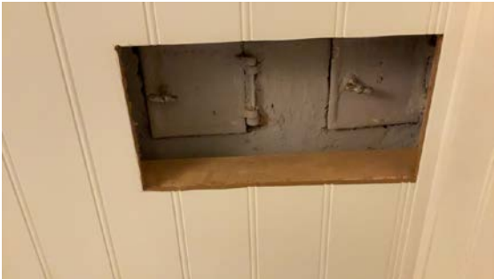
Sotluker skjult bak plater på bad/vaskerom.
