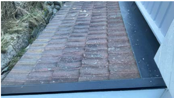
Takplater med bulker.
