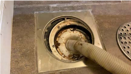
Sluk under dusjkabinett
