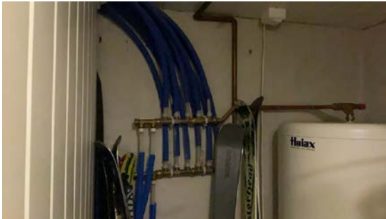
Vannrør kommer ut i rom uten sluk
