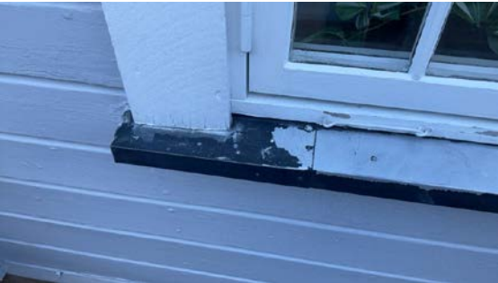
Maling på vindusbeslag flasser.
