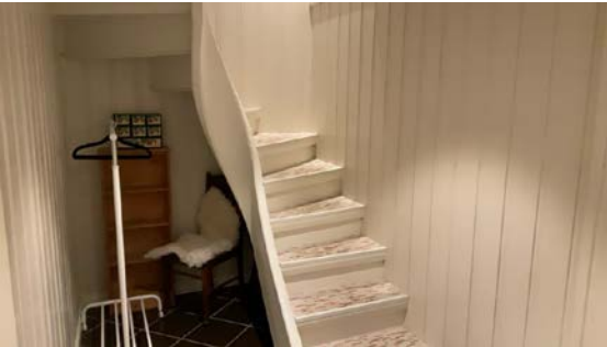
Trapp til kjeller uten rekkverk.
