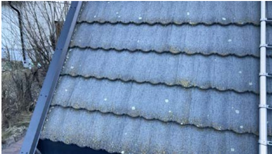
Noe mose på takplater.
