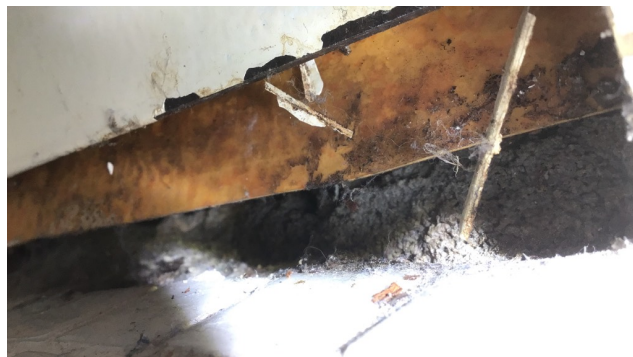
Skader i nedkant veggplate
