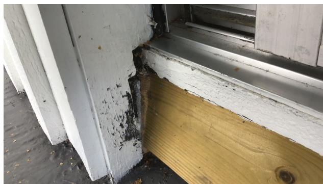
Utettheter i nedkant skyvedør
