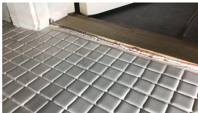
Mangelfull oppkant av membran under dør
