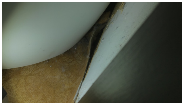
Belegg har løsnet fra vegg
