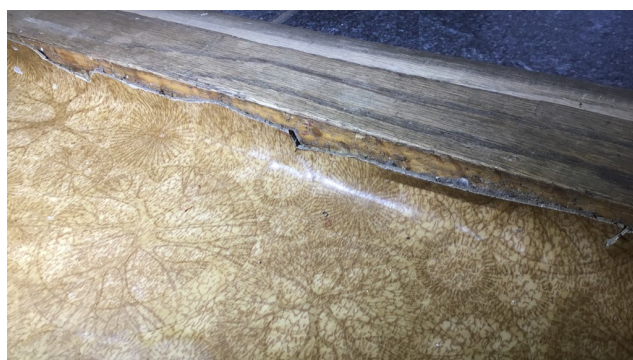
Skader i oppkant under dør på beleg
