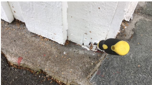
Fukt i nedkant kledning
