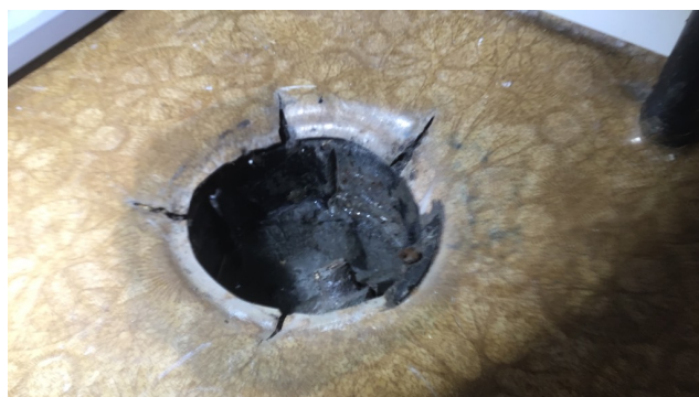
Skader i belegg rundt sluk
