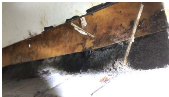
Skader i nedkant veggplate
