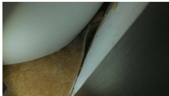
Belegg har løsnet fra vegg
