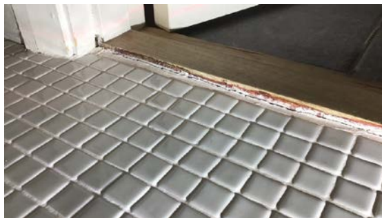
Mangelfull oppkant av membran under dør
