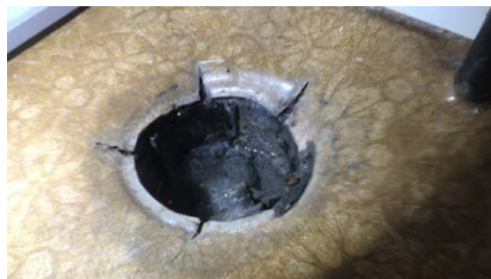
Skader i belegg rundt sluk
