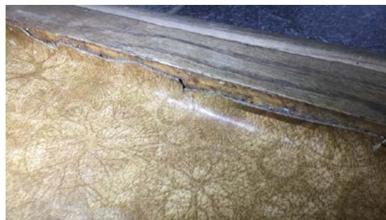
Skader i oppkant under dør på belegg
