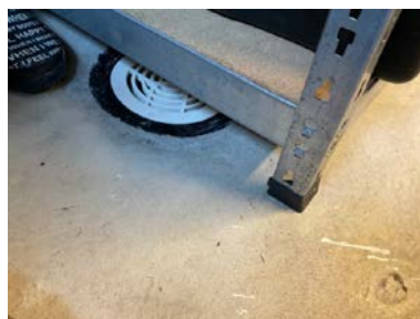
Sluk i bod under garasje
