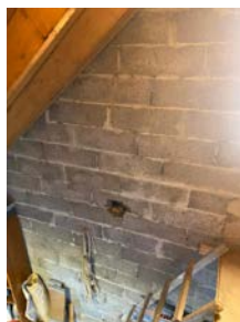
Vegg mellom garasje og bolig er ikke pusset
