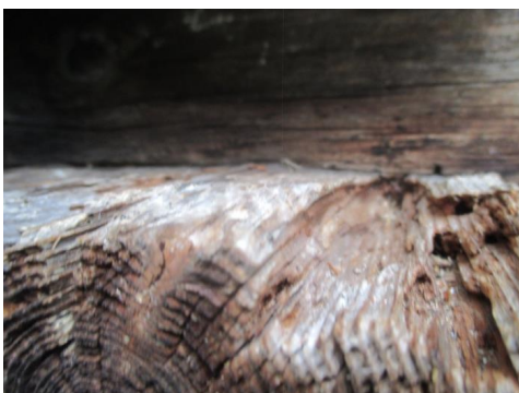
Større skader på ene lafteknutten.
