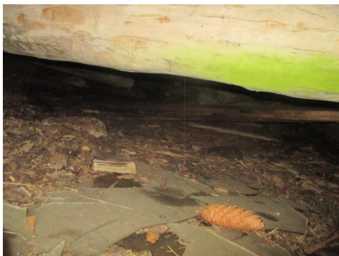
Svært lav høyde under det meste av hytta.
