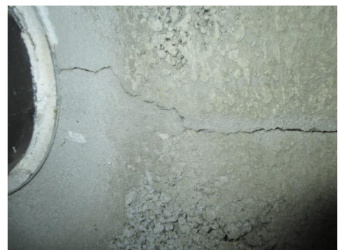
Mindre riss/sprekke i pipe ved røykrør.
