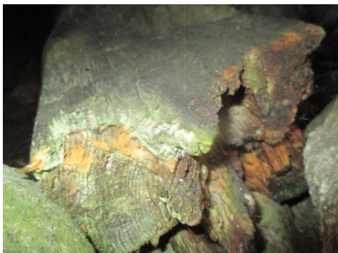
Ene bærestokken har råteskader/skadet.
