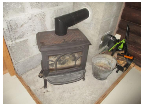
Elementpipe med vedovn og sotluke i stue.
