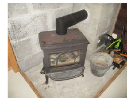
Elementpipe med vedovn og sotluke i stue.
