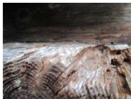
Større skader på ene lafteknutten.
