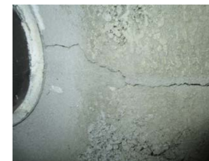
Mindre riss/sprekk i pipe ved røykrør.
