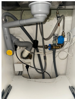
Røropplegg i kjøkkenbenk med Waterguard
