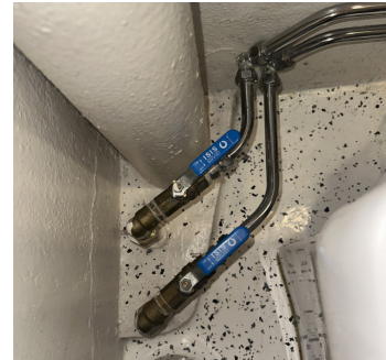
Stoppekraner plassert på bad
