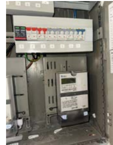
Sikringsskap med automatsikringer.
