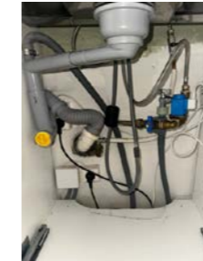
Røropplegg i kjøkkenbenk med Waterguard
