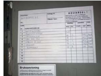
Kursoversikt i sikringsskap
