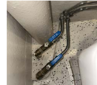
Stoppekraner plassert på bad
