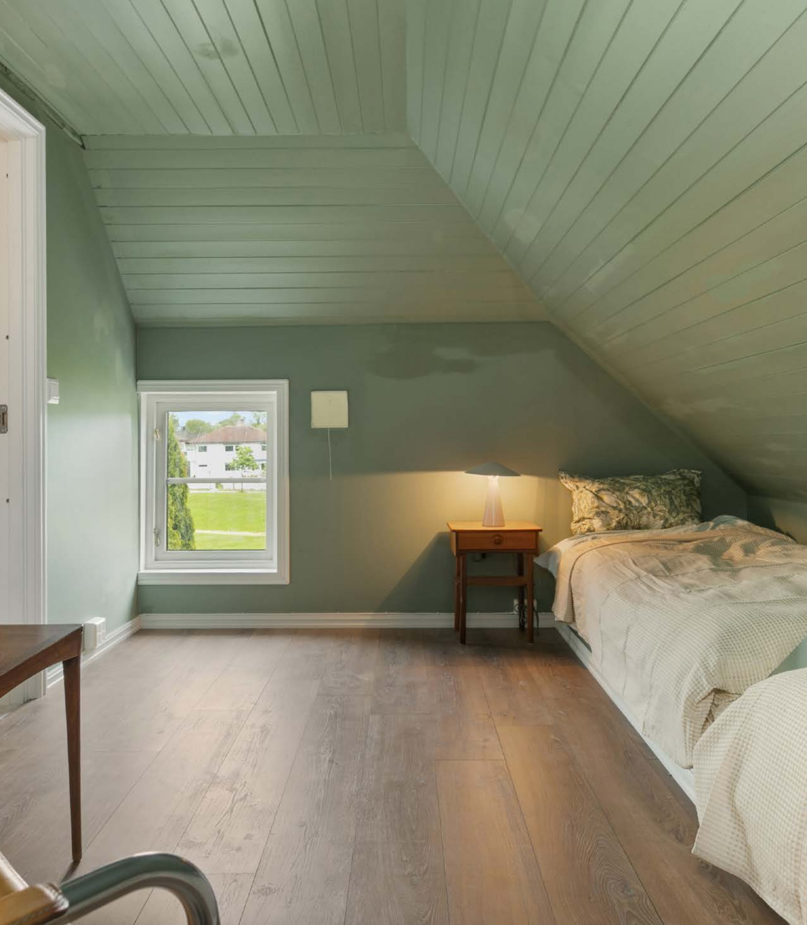
Rom på loft blir idag benyttet som soverom av eier. Dog er ikke dette godkjent rom for varig opphold.
