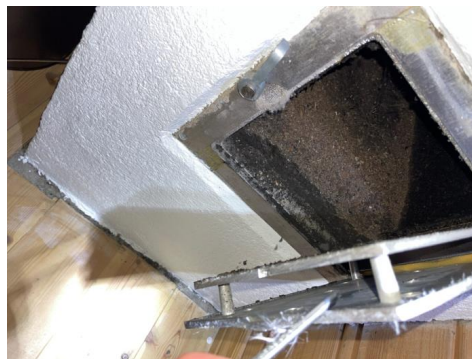
Manglende ubrennbar plate under sotluke/pipe kjøkken. Alt. Sotlukestein.
