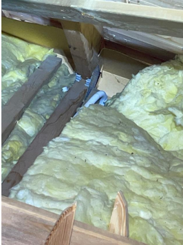
Manglende isolasjon rundt kabel.
