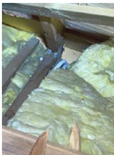
Manglende isolasjon rundt kabel.
