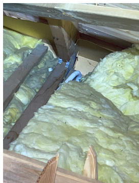
Manglende isolasjon rundt kabel.
