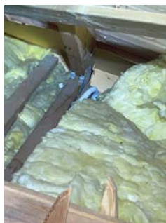
Manglende isolasjon rundt kabel.
