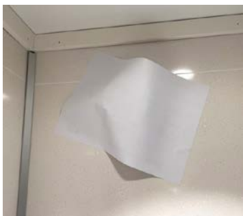
Avtrekksventil bestod papirtesten
