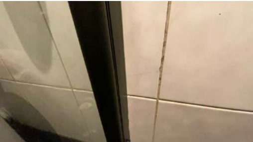
Sprekk i en veggflis.
