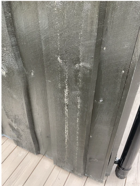
Utslag av kvae i kledning.
