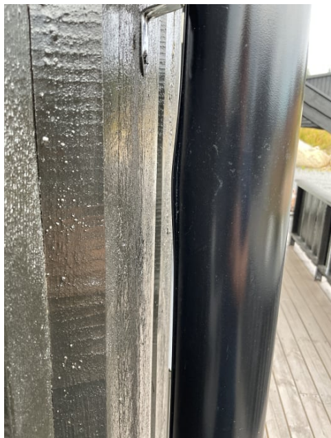
Frostsprenng i nedløp.
