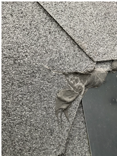
Sprekk i shingel ved pipe.
