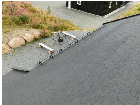
Montert snøfanger over inngangsparti.
