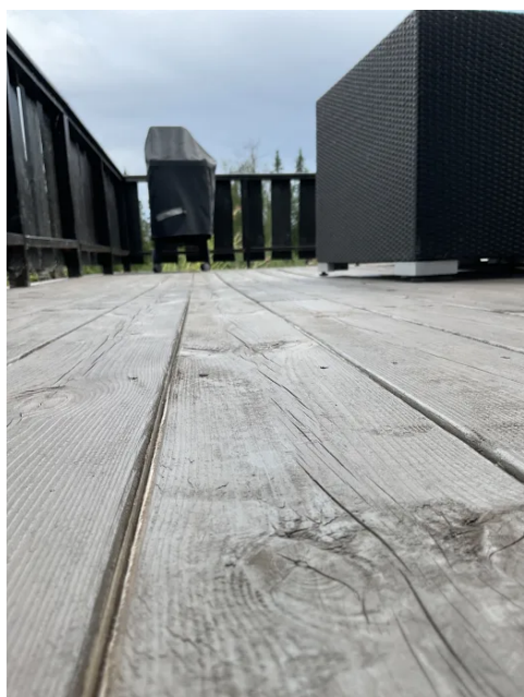
Skjevheter i gulv på terrasse.
