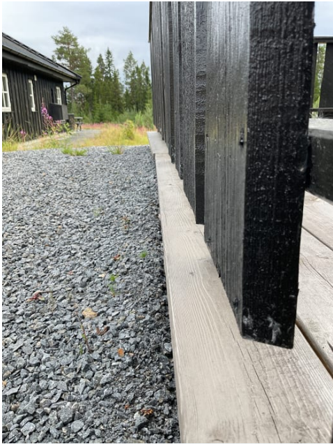
Tilbygg terrasse er skjev i forhold til eldre terrasse.
