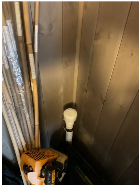
Vakumventil for lufting av klaokk.
