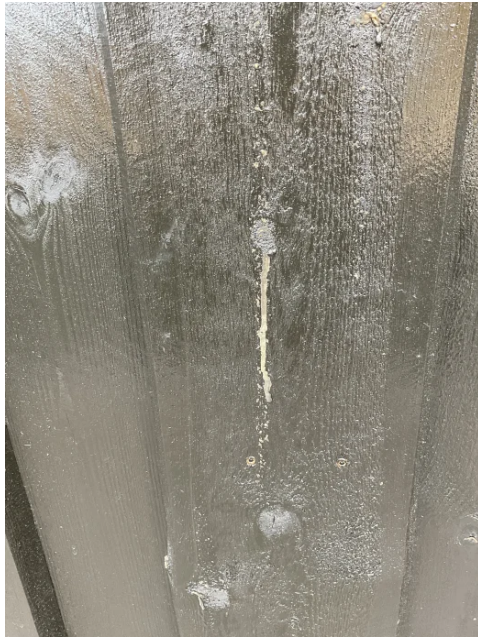
Utslag av kvae i kledning.
