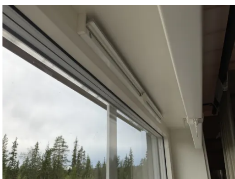
Spalteventiler i vinduer.
