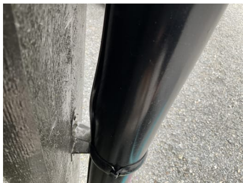
Frostsprenng i nedløp.
