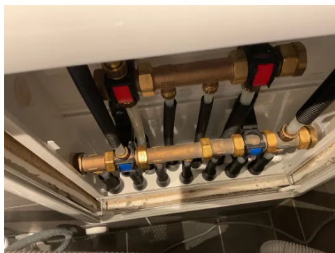
Fordelerskap for vann.
