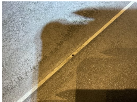
Hull i flisfug.
