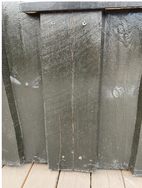
Sprekk i kledning.
