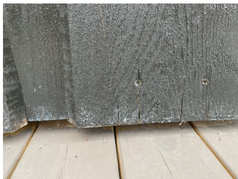
Sprekk i kledning.
