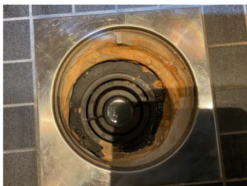
Ikke kontrollerbar utførelse av membran ved sluk.
