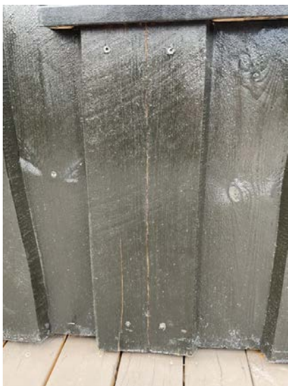
Sprekk i kledning.
