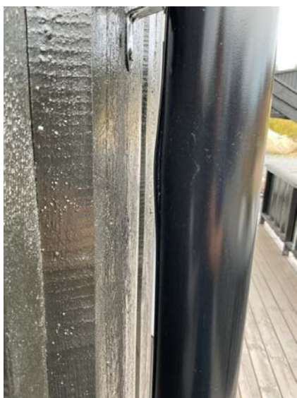
Frostsprenng i nedløp.
