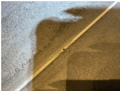
Hull i flisfug.
