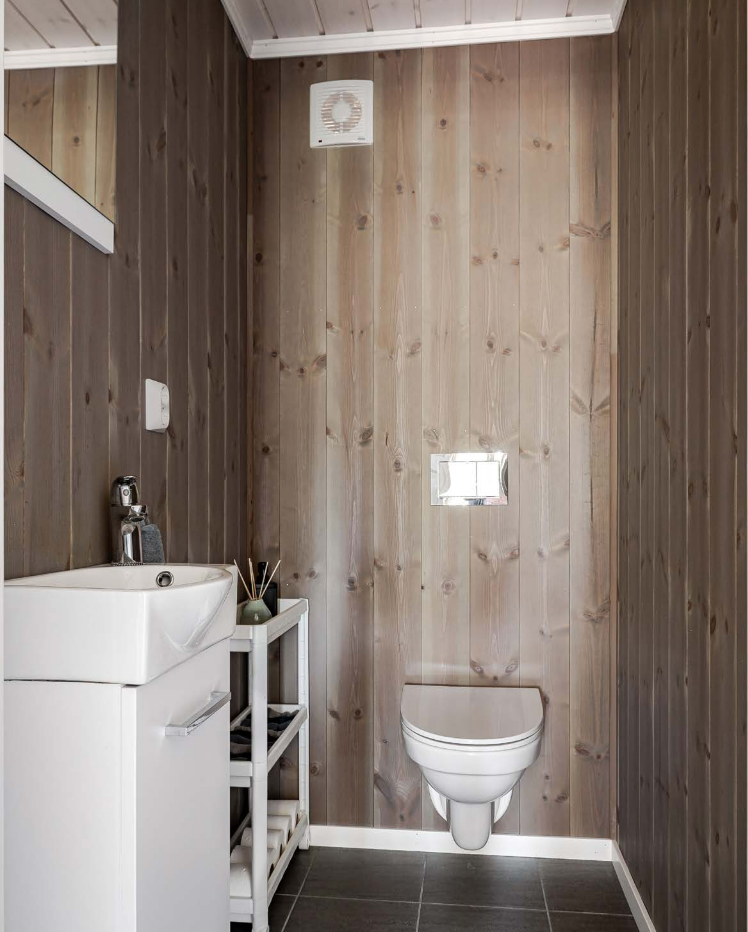
I 1. etasje er det også et praktisk ekstra toalettrom med flislagt gulv og mekanisk avtrekk. Toalettrommet er utstyrt med servantskap med speil over og vegghengt toalett.
