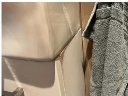
Skade på innredning.
