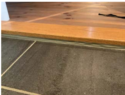
Manglende oppbrett av membran ved dør.
