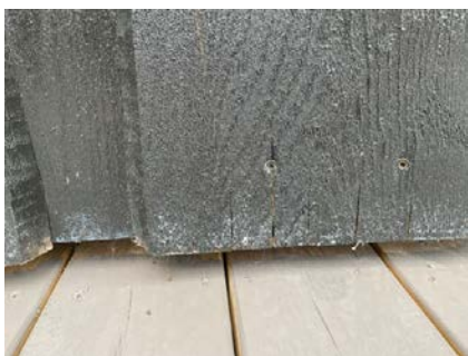
Sprekk i kledning.
