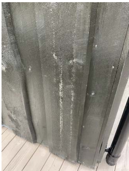
Utslag av kvae i kledning.
