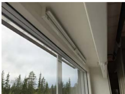
Spalteventiler i vinduer.
