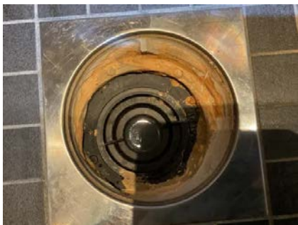
Ikke kontrollerbar utførelse av membran ved sluk.
