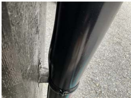
Frostsprenng i nedløp.
