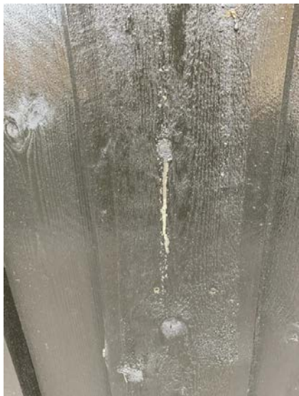
Utslag av kvae i kledning.
