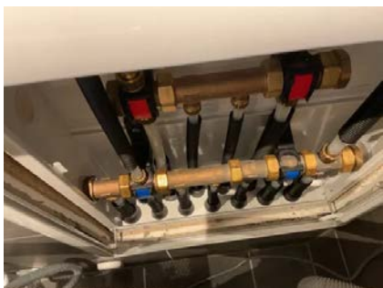
Fordelerskap for vann.
