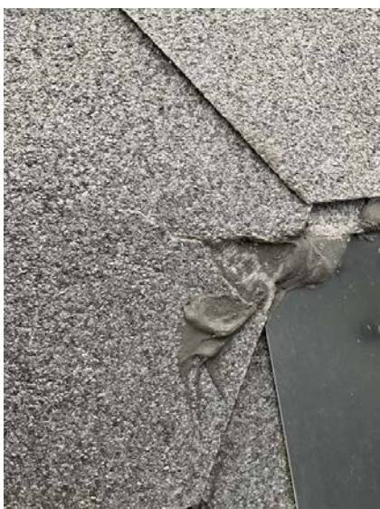
Sprekk i shingel ved pipe.
