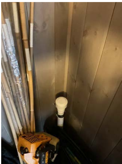
Vakumventil for lufting av kloakk.
