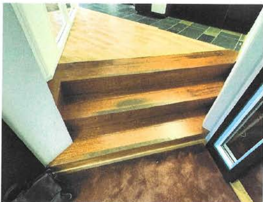
Eksempel på div. overflater. Og slitasje på overflaten på trapp.
