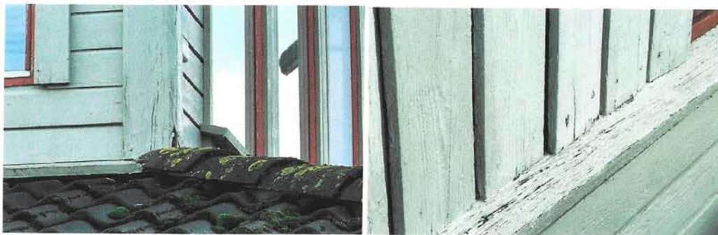
Eksempel på kledning som er slit og som er oppsprukket.
