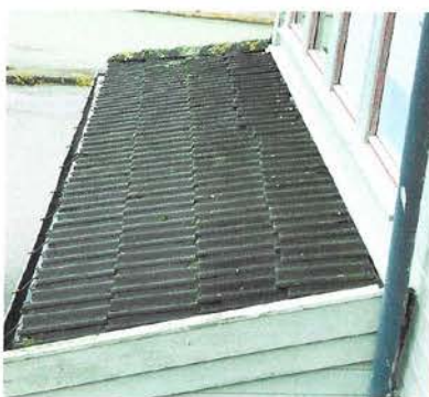
Takstein bør legges på plass.
