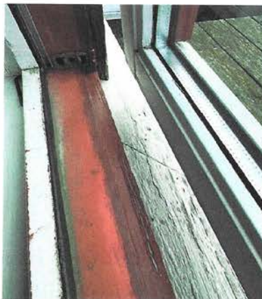
Eksempel på noe slitt treverk.
