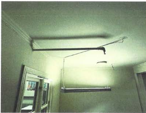
Eksempel på rør med sprinklerhode.
