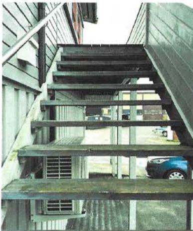
Åpninger mellom trinn.
