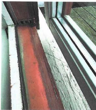
Eksempel på noe slitt treverk.
