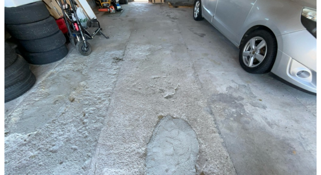
Synlig elde og slitasje.
