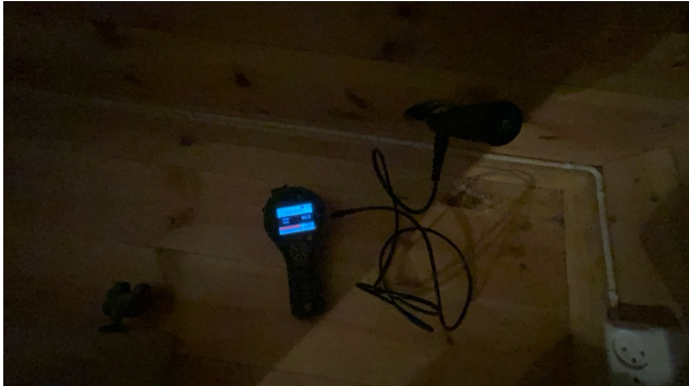
Utført hulltaking på rom under terreng. Påvist høy fuktprosent.
