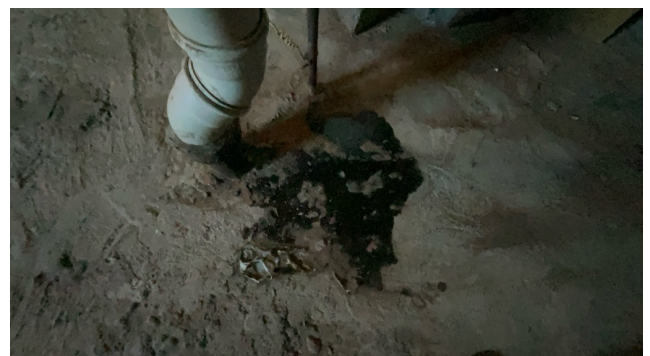
Synlig vannsamlinger på betongsåle over avløpsrøret i kjeller. Årsak til dette er uklart, men det kan ikke utelukkes utskiftninger.
