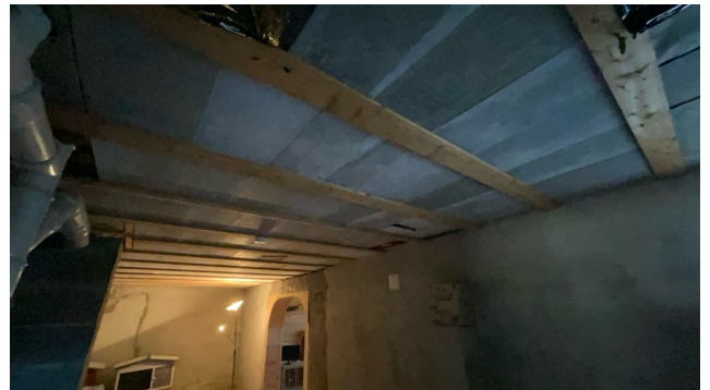
Synlige eternittplater i himling i kjeller.
