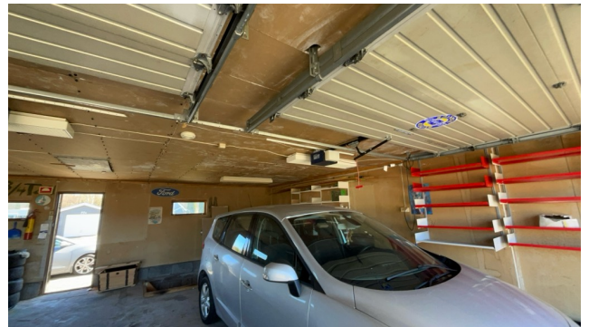
Synlig elde og slitasje.
