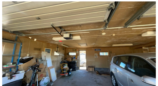
Synlig elde og slitasje.
