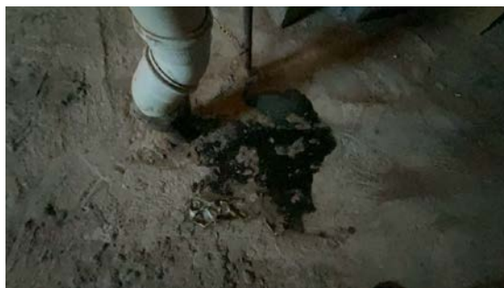
Synlig vannsamlinger på betongsåle over avløpsrøret i kjeller. Årsak til dette er uklart, men det kan ikke utelukkes utskiftninger.
