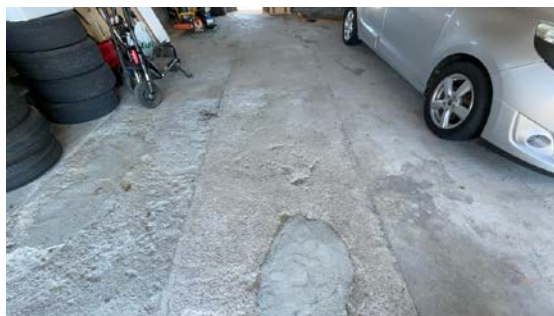
Synlig elde og slitasje.
