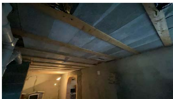
Synlige eternittplater i himling i kjeller.
