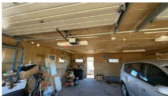
Synlig elde og slitasje.
