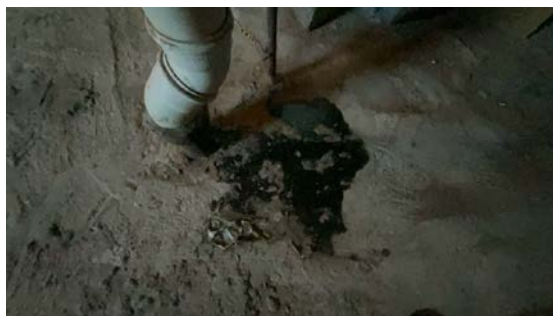
Synlig vannsamlinger på betongsåle over avløpsrøret i kjeller. Årsak til dette er uklart, men det kan ikke utelukkes utskiftninger.
