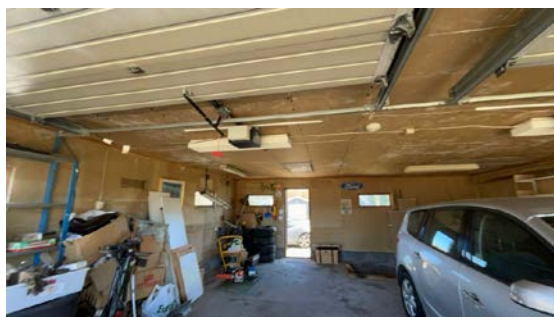
Synlig elde og slitasje.
