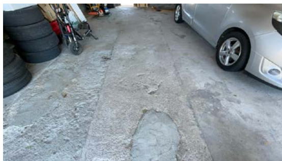
Synlig elde og slitasje.
