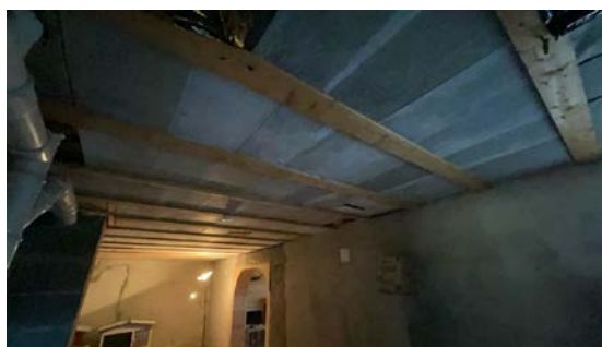
Synlige eternittplater i himling i kjeller.
