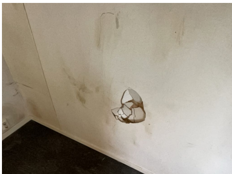
Skade i veggplate i kjøkken.
