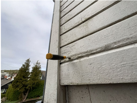
Råte i kledning på vegg ved inngangsparti.
