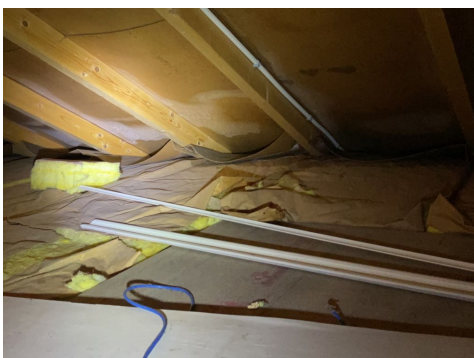
Enkelte luftespalter ved takfot er tilsynelatende reduserte.
