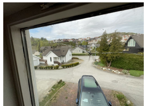
Sprukket vindusglass i stue.
