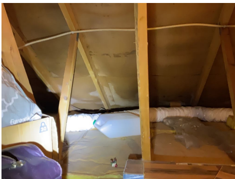
Merker etter kondens i sutak mot takfot på loft.
