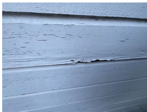
Råte i kledning på vegg ved balkong.
