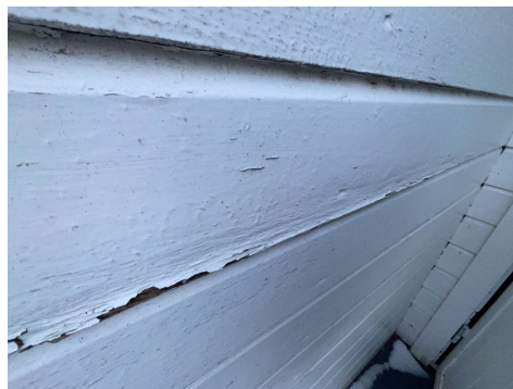
Råte i kledning på vegg ved balkong.
