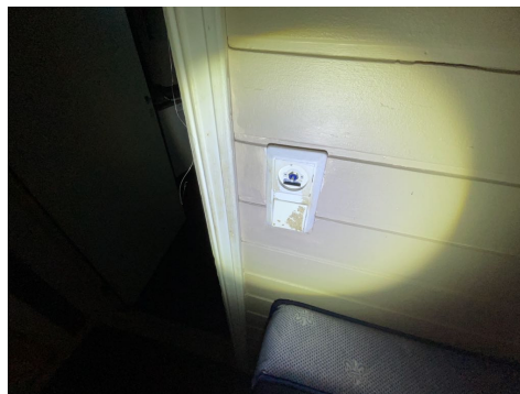
Dimmer mangler "vridehjul".
