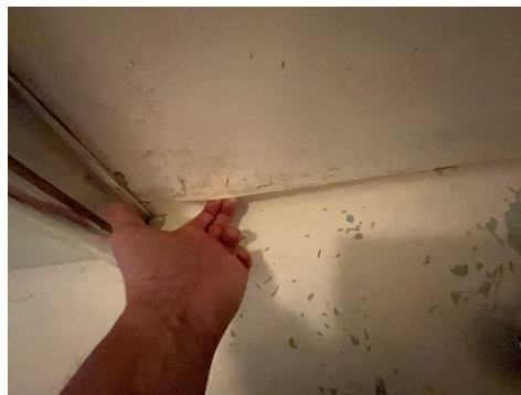
Belegg på vegger i dusjnise er løst i nedre ende.
