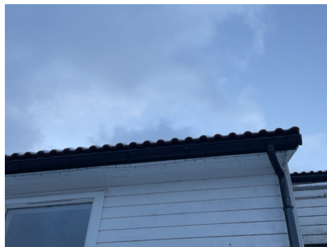
Det er ikke montert snøfangere på tak.
