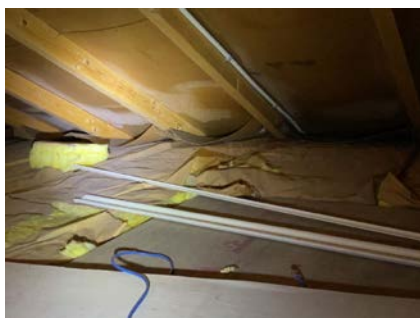
Enkelte luftespalter ved takfot er tilsynelatende reduserte.
