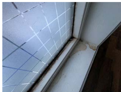
Store tegn til kondens i vinduskarm i stue.
