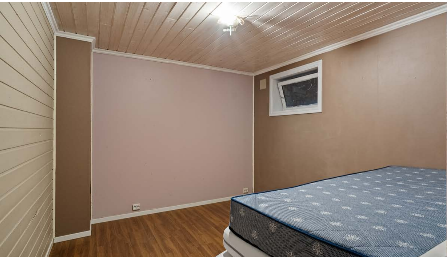
Innredet rom (ikke godkjent til boligformål - kun godkjent som bod)
