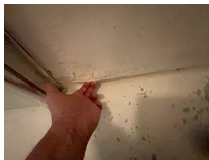
Belegg på vegger i dusjnise er løst i nedre ende.
