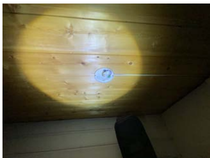
Røykvarsler manglet i vaskerom på befaringsdagen.
