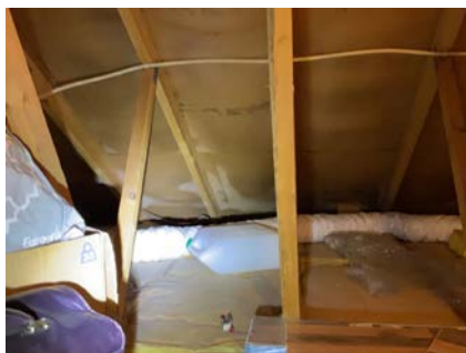
Merker etter kondens i sutak mot takfot på loft.
