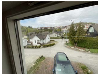
Sprukket vindusglass i stue.
