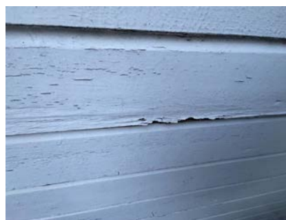
Råte i kledning på vegg ved balkong.
