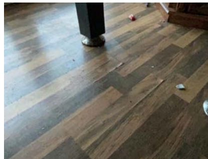
Skader i laminatskjøter i stue.
