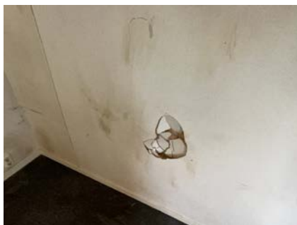
Skade i veggplate i kjøkken.
