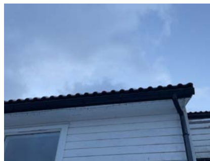
Det er ikke montert snøfangere på tak.
