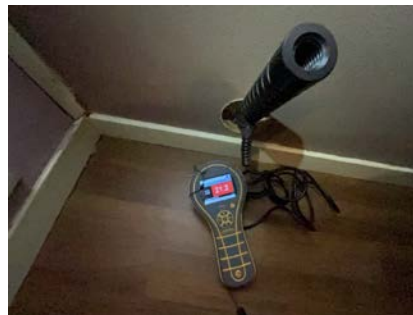
Det ble på befaringdagen påvist 21,1 vektprosent fukt i trevirke i påforet vegg.
