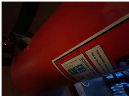
Slokkingsapparat er eldre enn 10 år.
