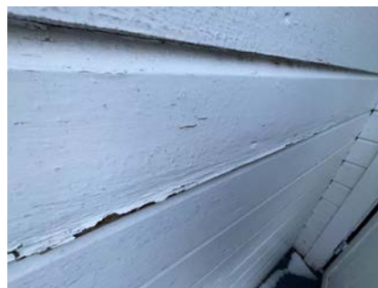
Råte i kledning på vegg ved balkong.
