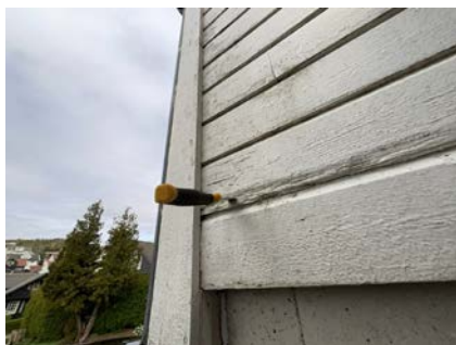
Råte i kledning på vegg ved inngangsparti.
