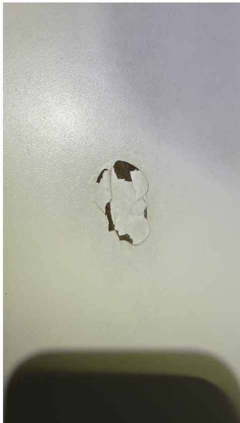
Eksempelbilde av sår/ skade i benkeplate.
