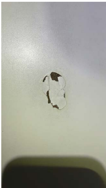
Eksempelbilde av sår/ skade i benkeplate.
