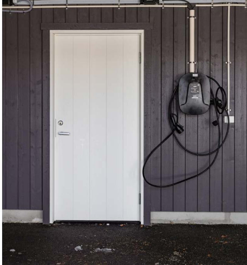
Det er montert elbillader og det er adgang til utvendig bod på ca. 5 m 2 .
