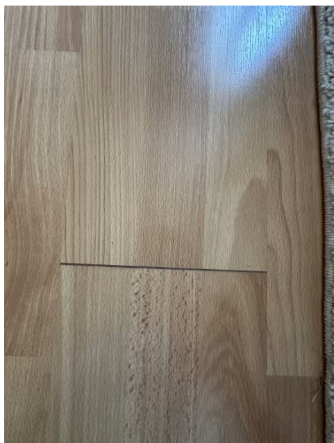
Det registreres enkelte glipper i skjøter ved gulv.
