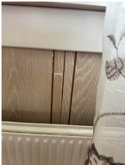
Det registreres sprekk i vegg bak radiator.
