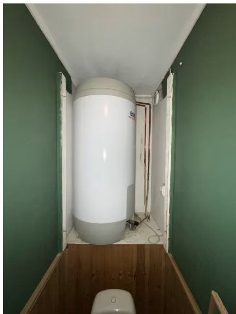
Viser bereder plassert i kasse på toalettrom.
