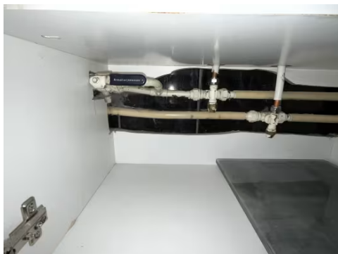
Viser hovedstoppekran plassert på bad.
