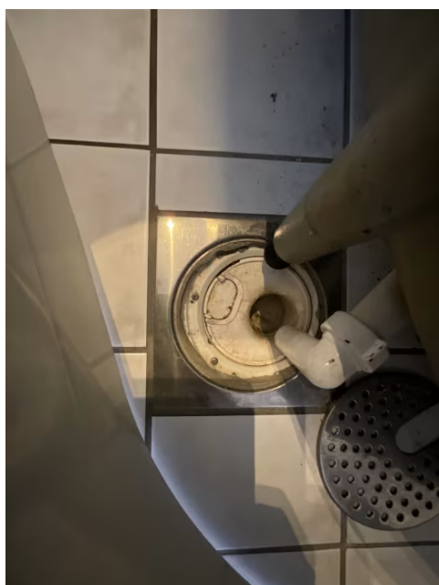
Viser sluk under dusjkabinett.
