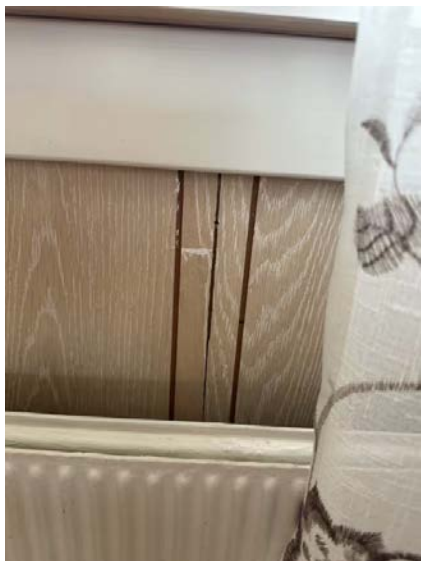
Det registreres sprekk i vegg bak radiator.
