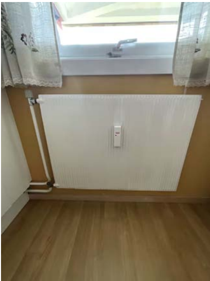
Viser radiator montert på kjøkken.
