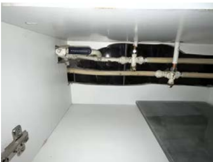
Viser hovedstoppekran plassert på bad.
