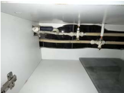
Viser hovedstoppekran plassert på bad.
