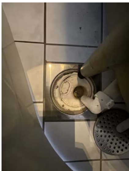
Viser sluk under dusjkabinett.
