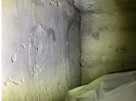
Sprekk i grunnmur i overgang opprinnelig del og tilbygg (garasjerom)
