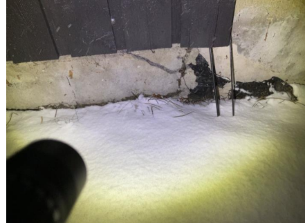
Sprekker i fundamentene under tilbygget.
