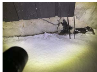
Sprekker i fundamentene under tilbygget.
