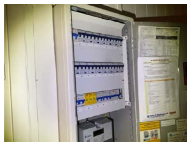
El-anlegg med automatsikringer. I hovedsak åpent ledningsnett. Sikringskap er plassert i gang i 1. etasje.
