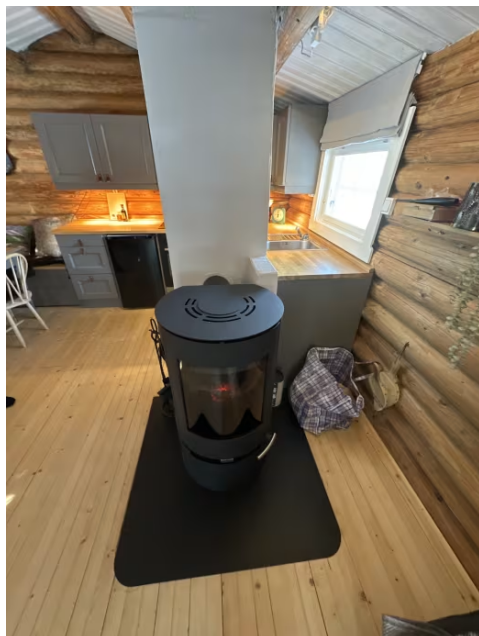
Viser ildsted montert i stue.
