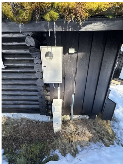
Viser inntaksskap og målerskap.
