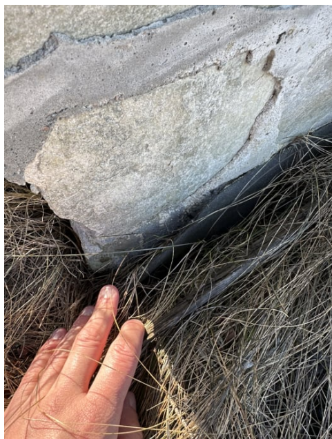
Viser løs tekking rundt pipe.
