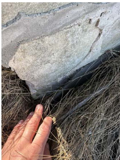
Viser løs tekking rundt pipe.
