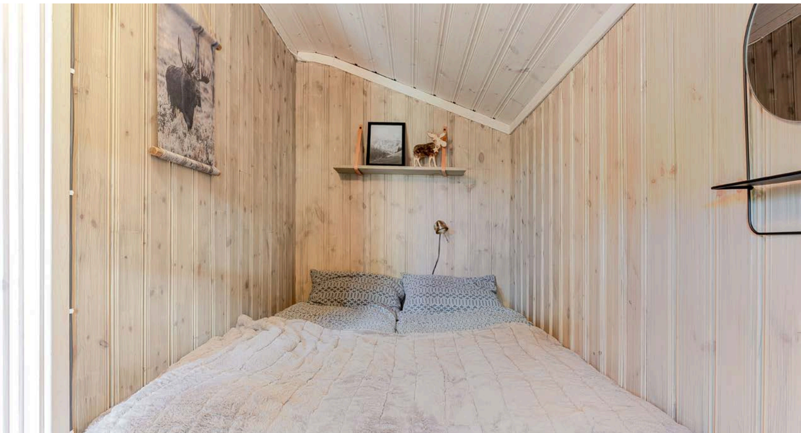
Pent og oppgradert rom innredet som soverom. Rommet er ikke godkjent for varig opphold.
