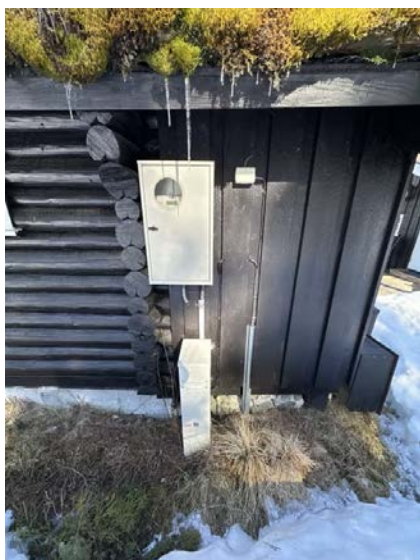
Viser inntaksskap og målerskap.
