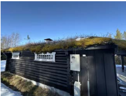
Det er ikke etablert takrenner.
