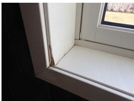
Skader i vindusbrett.
