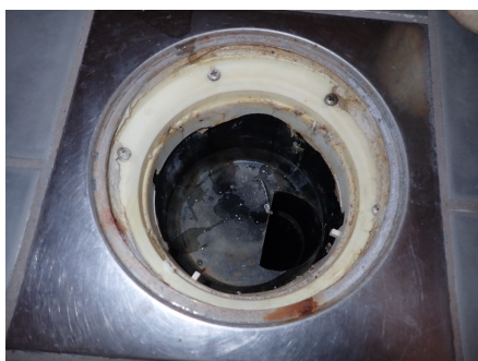
Synlig tettesjikt i sluk
