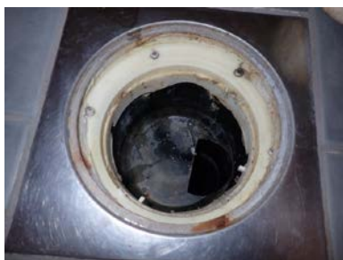
Synlig tettesjikt i sluk
