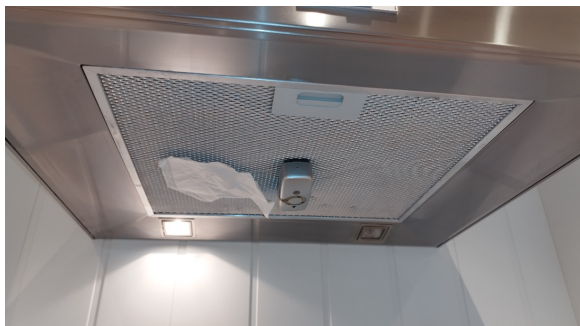
Test av avtrekket.
