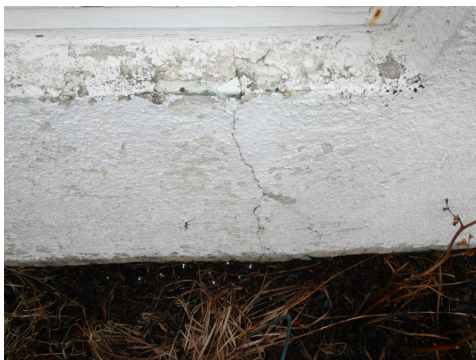
Grunnmuren har sprekkdannelser.
