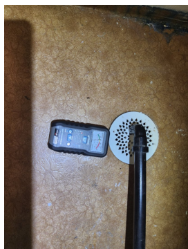
Fuktmåling. Det tørreste stedet er akkurat rundt sluken.
