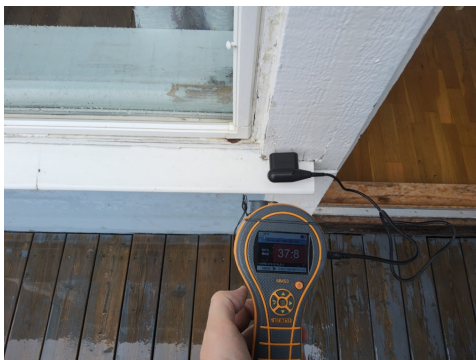
Forhøyede fuktverdier i omramming rundt vindu.
