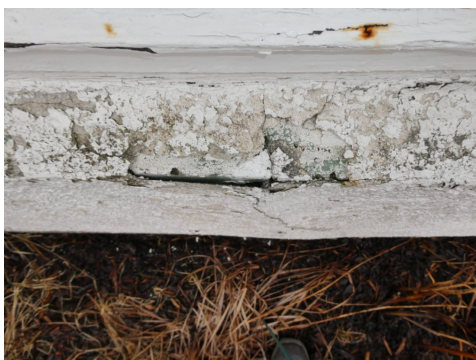
Grunnmuren har sprekkdannelser.
