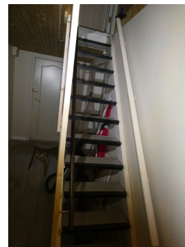
Mangler rekkverk på ene siden
