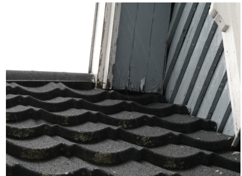
Over tilbygg er raftekassebord og vindskibord ført veldig nært taktekkning. Dette gir endeved tilgang på fukt. Usikkert om dette er råte, eller bare fuktskade.
