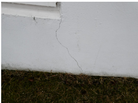
Mindre sprekker i grunnmur
