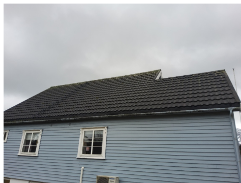
Bildet viser taktekking av stål med ru overflate som er relativt mye begrodd med mose/lav. Bildet er tatt mot husets bakside.
