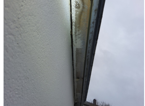
Lite/ingen lufting bak kledning.
