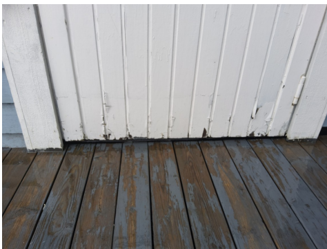
Utvendig fukt og råteskader.
