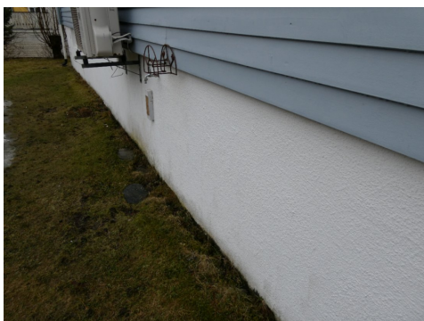
Grunnmuren har sprekkdannelser.
