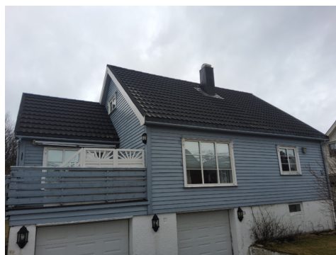
Bildet viser taktekking av stål med ru overflate som er relativt mye begrodd med mose/lav. Bildet er tatt mot husets fremside.
