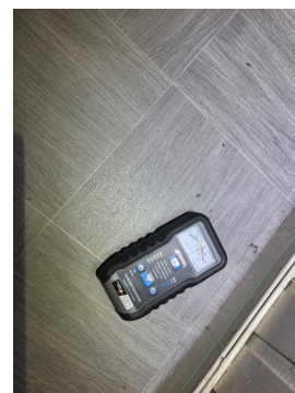
Forhøvede fuktverdier i kjellergulv
