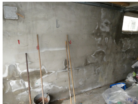
Indikasjoner på fukt i garasje
