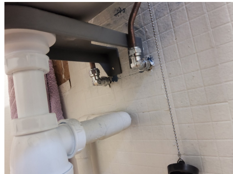
Ikke fagmessige gjennomføringer
