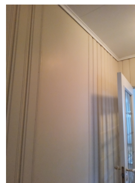
Ukjent plate på pipe i gang 1 etg.
