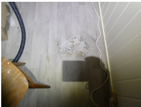
Fuktskade der fryseboks har stått.
