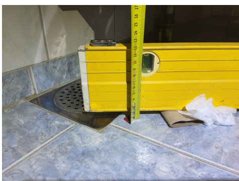
Fall fra dusjkabinett mot sluk
