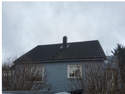
Bildet viser taktekking av stål med ru overflate som er relativt mye begrodd med mose/lav
