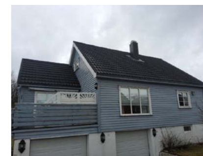
Bildet viser takteking av stål med ru overflate som er relativt mye begrodd med mose/lav. Bildet er tatt mot husets fremside.
