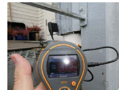
Rundt inngangsparti er det høyt fuktnivå i kledning nederst til høyre for døra. Det er et lite område, men her er det påbegynte råteskader.
