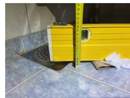
Fall fra dusjkabinett mot sluk
