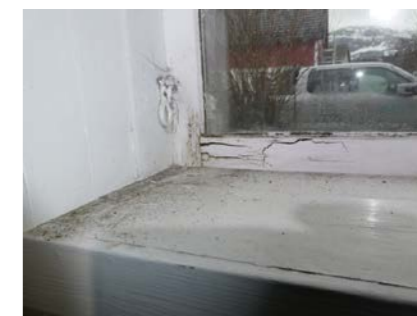
Vinduer i kjeller må regnes for å være oppbrukte.
