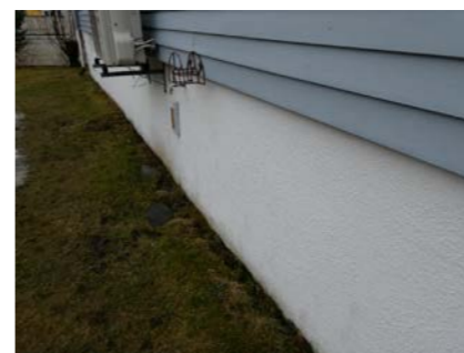
Grunnmuren har sprekkdannelser.
