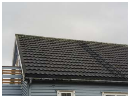
Bildet viser taktekkning av stål med ru overflate som er relativt mye begrodd med mose/lav
