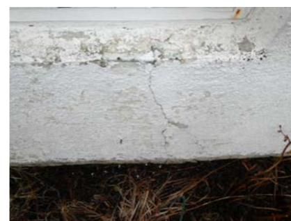
Grunnmuren har sprekkdannelser.
