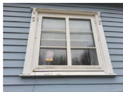
Vindu fra utsiden. En del maling har flasket av
