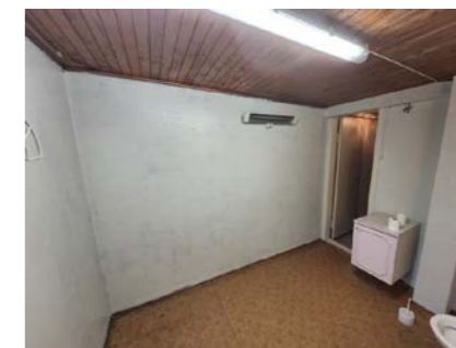
Vaskerom i kjeller
