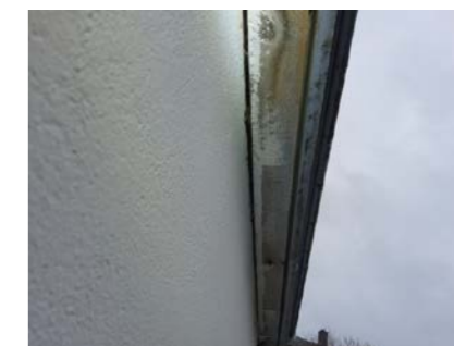
Lite/ingen lufting bak kledning.
