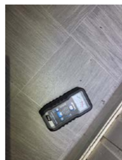
Forhøyede fuktverdier i kjellergulv
