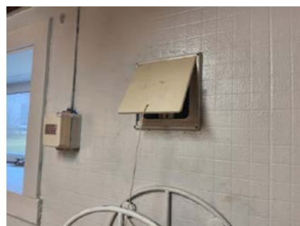
Ventil i yttervegg
