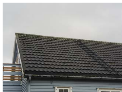
Bildet viser taktekkning av stål med ru overflate som er relativt mye begrodd med mose/lav
