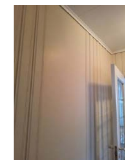
Ukjent plate på pipe i gang 1 etg.
