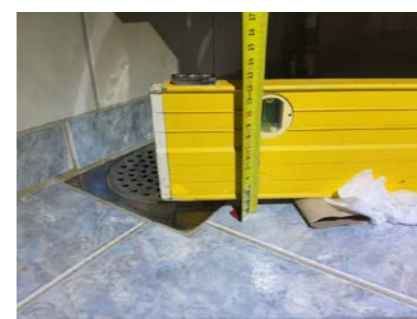
Fall fra dusjkabinett mot sluk
