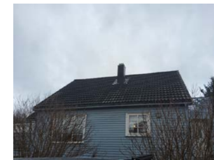
Bildet viser takteking av stål med ru overflate som er relativt mye begrodd med mose/lav
