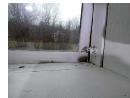
Vinduer i kjeller må regnes for å være oppbrukte.
