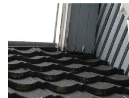
Over tilbygg er raftekassebord og vindskibord ført veldig nært taktekkning. Dette gir endeved tilgang på fukt. Usikkert om dette er råte, eller bare fuktskade.
