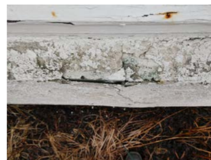
Grunnmuren har sprekkdannelser.
