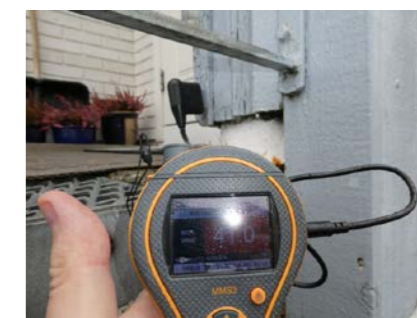
Rundt inngangsparti er det høyt fuktnivå i kledning nederst til høyre for døra. Det er et lite område, men her er det påbegynte råteskader.
