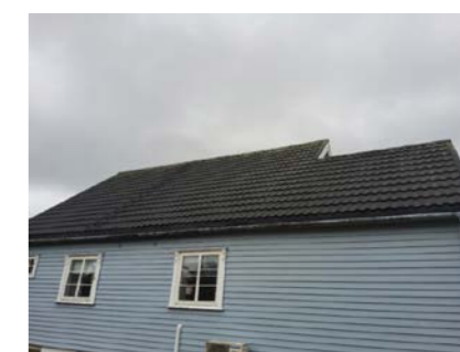
Bildet viser takteking av stål med ru overflate som er relativt mye begrodd med mose/lav. Bildet er tatt mot husets bakside.
