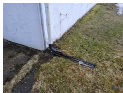
Bildet viser delvis bortledning av vann. Men det er flatt terreng og vannet finner lett veien tilbake mot grunnmur
