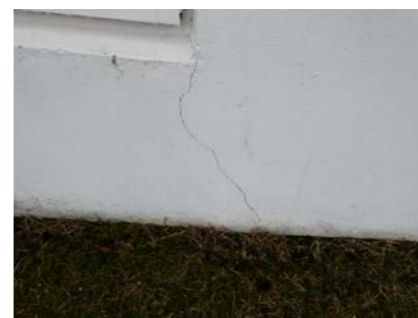
Mindre sprekker i grunnmur
