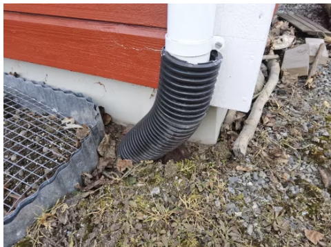
Takvann er ledet ned i drensør.
