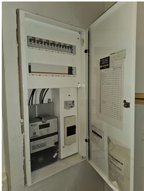
Sikringsskap er plassert i bod.
