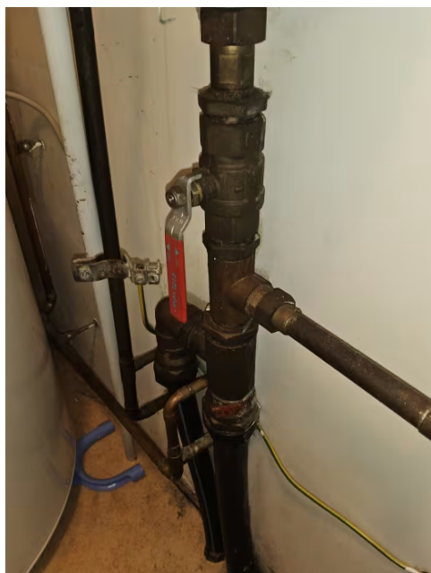
Hovedstoppekran er plassert på bod.
