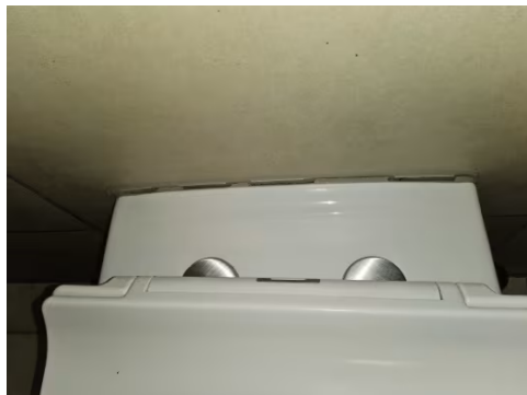
Elastiske fuger rundt toalett har manglende vedheft.
