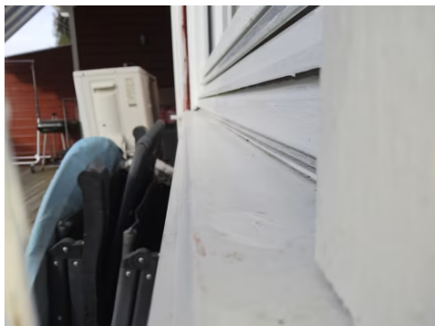
Det registreres vannbord/beslag uten fall.
