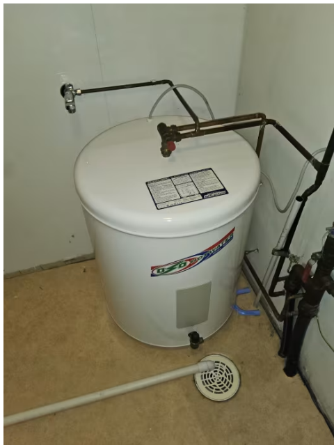
Varmtvannsbereder er plassert i bod.
