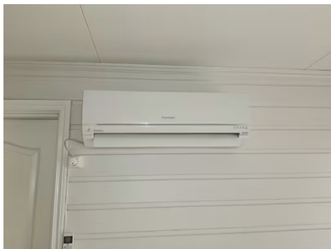
Varmepumpe er plassert i stue.
