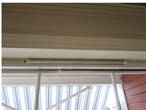
Naturlig ventilasjon fra spalteventiler i vinduer.
