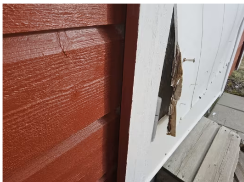
Dør til sportsbod bærer preg av skader/slitasje.
