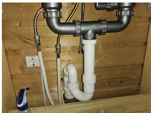
Leiligheten har synlige avløpsrør av plast.
