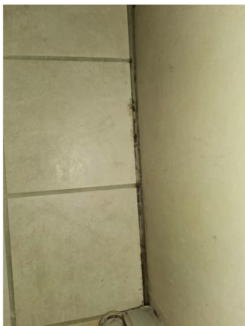
Det registreres sprekker i elastiske fuger mellom gulv og vegg.
