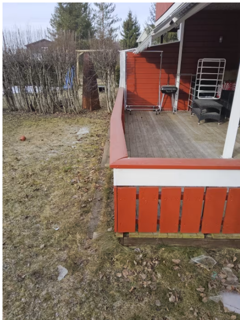
Bilde viser skjevheter i rekkverk.
